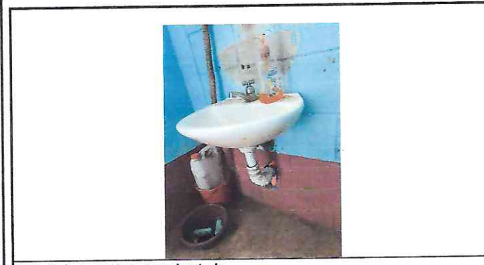
Foto 5: lavamanos en mal estado
