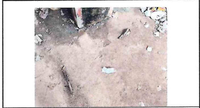
Foto 10: torta de cemento en mal estado
