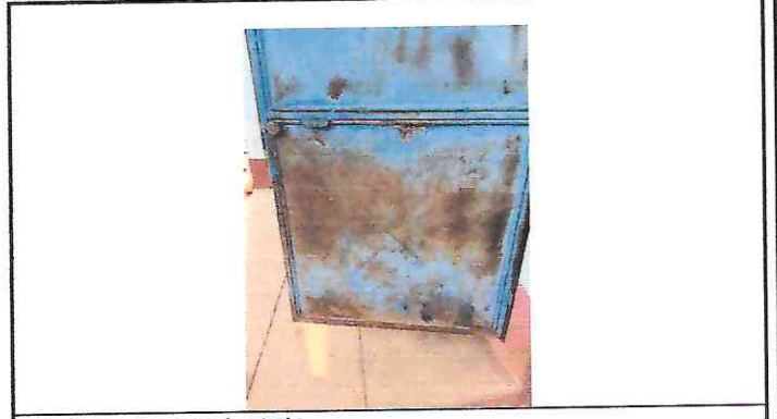
Foto 2: Puerta en mal estado
