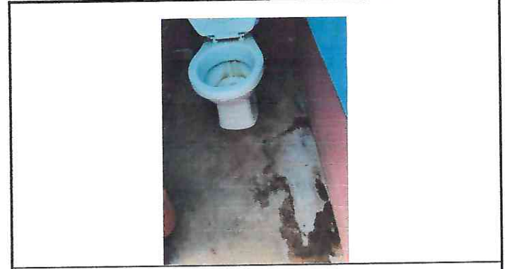
Foto 4: Sanitario en mal estado
