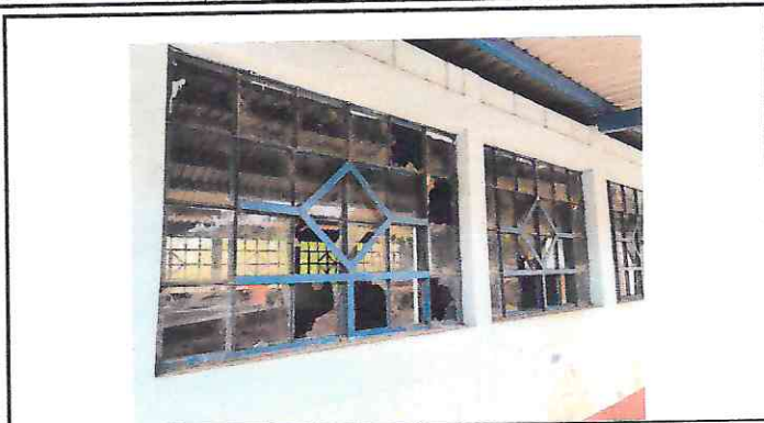
Foto 1: ventanas en mal estado, para ser sustituidas por balcón
