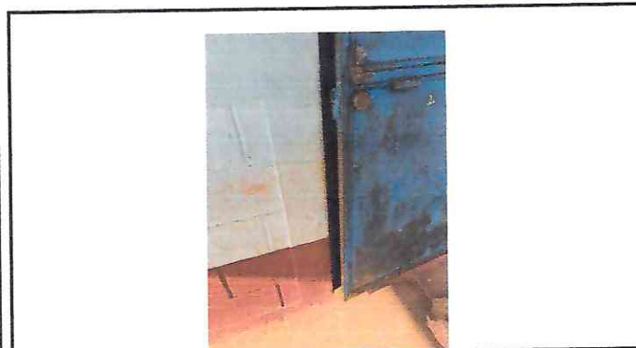
Foto 3: puerta de sanitario en mal estado
