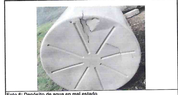
Foto 6: Depósito de agua en mal estado
